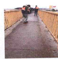
ATENCION A VULNERABILIDAD DEL PUENTE PEATONAL
