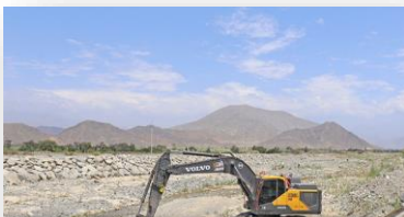
3 PUNTOS CRÍTICOS ENTRE NEPEÑA Y SAMANCO
